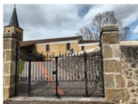
Eglise : Dérogation réalisée Rafraichissement place PMR à réaliser
